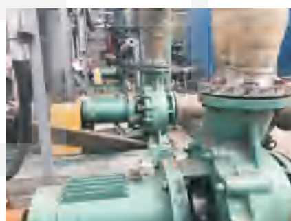
济源万洋冶炼现场产品（工艺泵）
