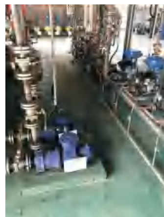
四川科伦药业（工艺泵）
